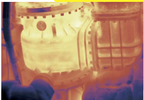
Thermografische Untersuchung einer Brennkammer
